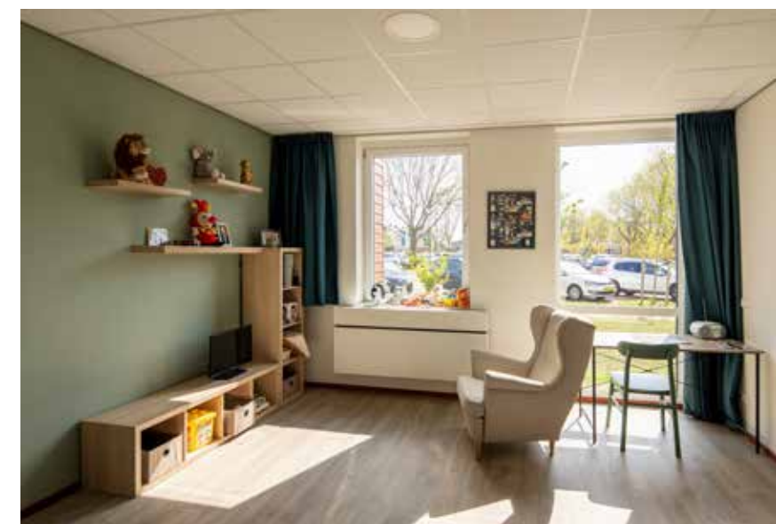
Door middel van sensoren werken de WTW-units automatisch en wordt in de zorgkamers en overige ruimtes een gezond binnenklimaat gerealiseerd met de benodigde hoeveelheid ventilatie.
