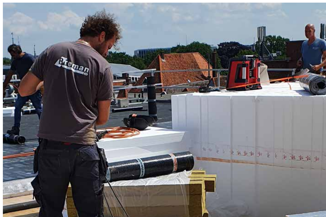
Breman verzorgt de centrale indeling van het watersysteem en de luchtkanalen, nuts-invoer, stekerbare installaties en gevelroosters bij het Broerenkwartier in Zwolle.
